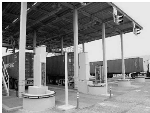
コンテナ・ターミナルゲート(トラック・スケール、放射線モニター他)
